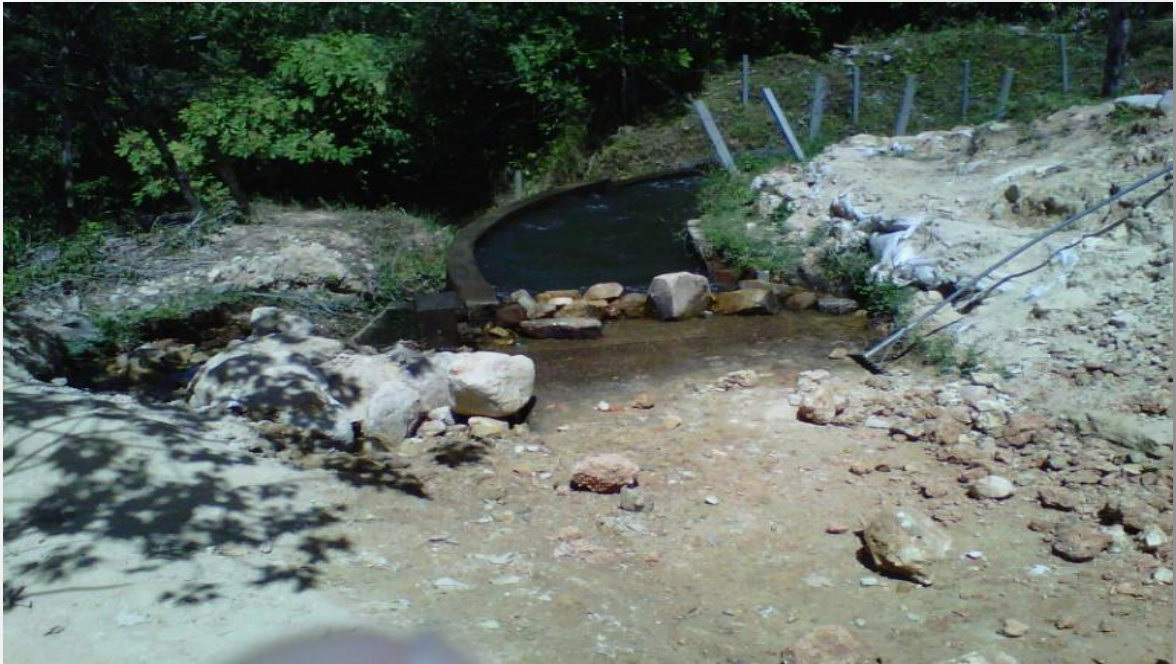
Imagen 7. Reconstrucción Box Couvert microcentral “Iquirá I “y tanque de compensación (reserva) y Desarenador Iquirá II
