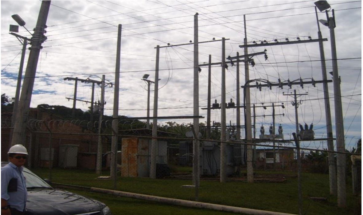
Imagen 3. Subestación de San Agustín
