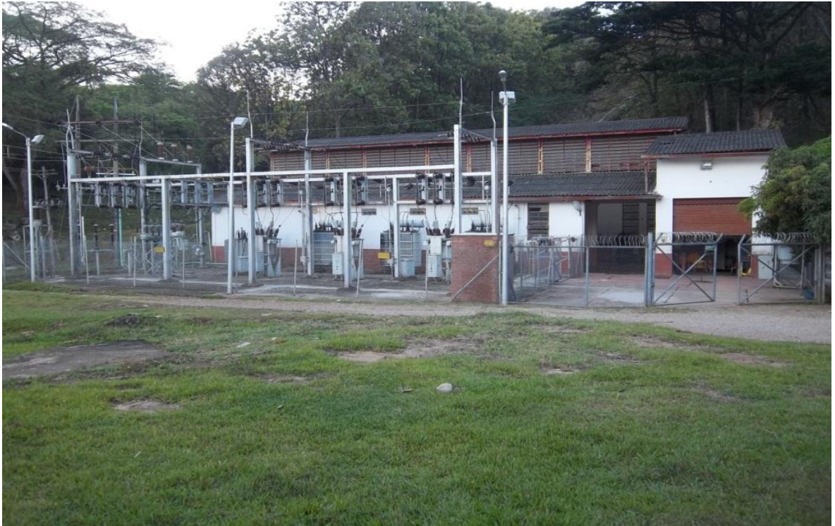
Imagen 4. Casa de Maquinas Íquira I
