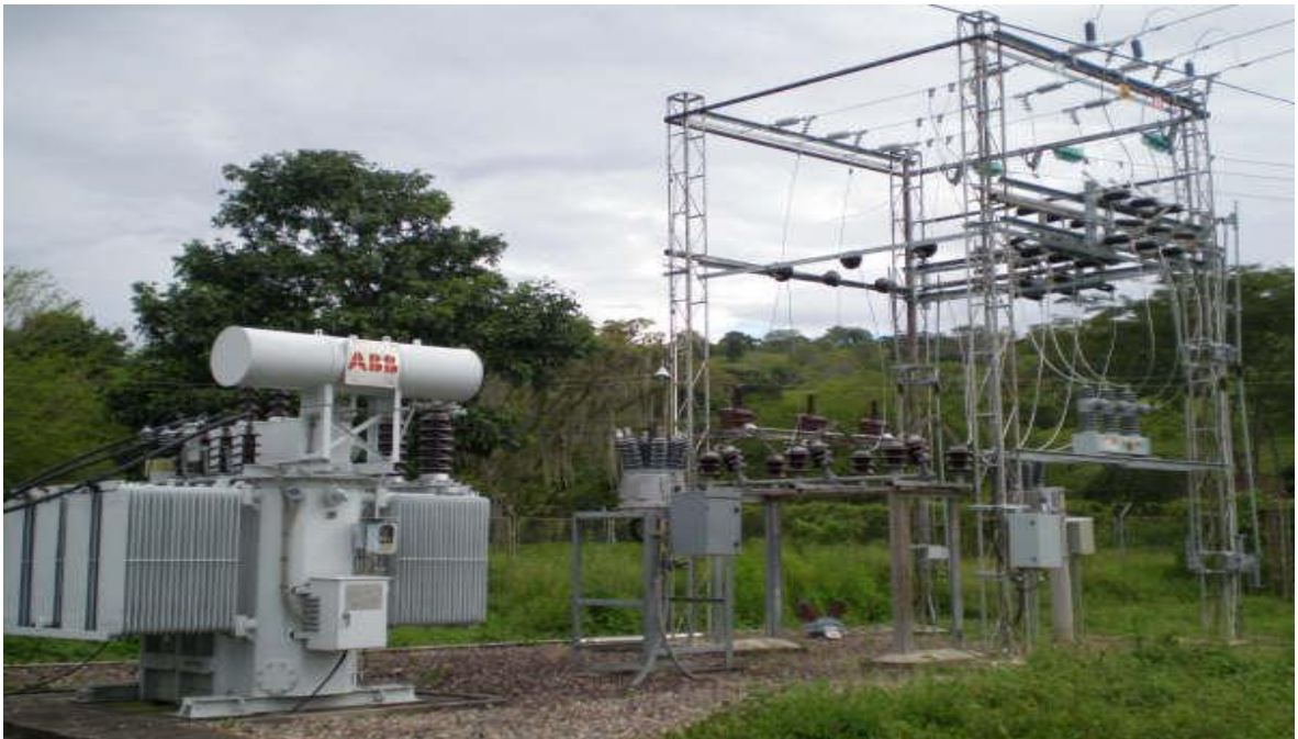
Imagen 2. Subestación de Timaná
