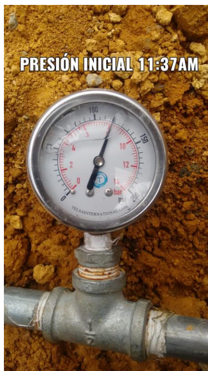
Imagen 7. INICIO PRUEBA DE PREZURIZACION NODO 116-123, CONSTRUCCION SISTEMA DE ACUEDUCTO RED MATRIZ CUATRO ESQUINAS- SANTA ANA. Fotografía. Fuente: elaboración propia.
