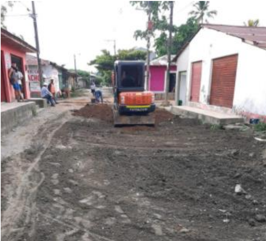
Figura 8. Nivelación del terreno la construcción del sistema para manejo de aguas residuales urbanas del municipio de Nechí, Antioquia (Fuente: Registro fotográfico de la empresa).
