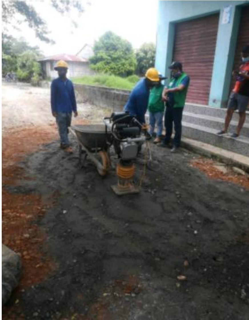
Figura 7. Supervisión de la actividad de compactación del suelo a percusión en la construcción del sistema para manejo de aguas residuales urbanas del municipio de Nechí, Antioquia (Fuente: Registro fotográfico de la empresa).
