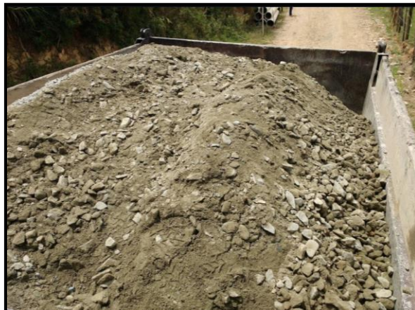
Imagen 5. MATERIAL PARA LLENO DE ZANJA BASE GRANULAR. CONSTRUCCIÓN DE SISTEMA DE ACUEDUCTO CUATRO ESQUINAS, SANTA ANA. Fotografía. Fuente: Elaboración Propia.
