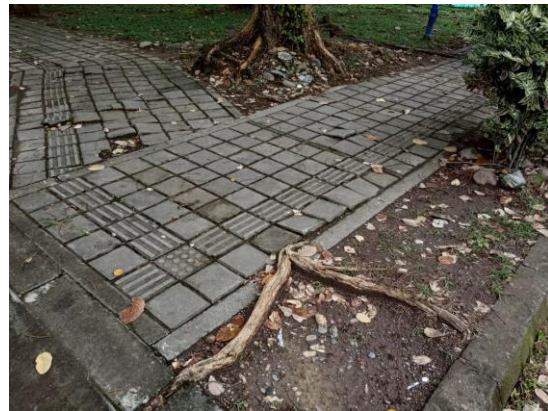
Figura 3 Afectación a la infraestructura pública. Fuente: Propia
