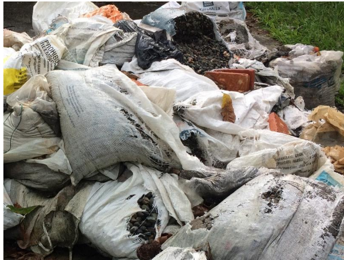
Tipo 4: residuos por desperdicio de mezcla de concreto
